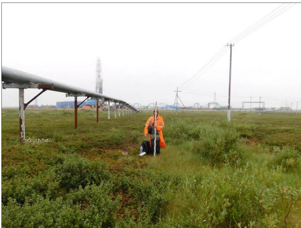
Рис. 67 – Фото. НАО, Заполярный район. Западно-Хоседаюское месторождение. ТФ № 33. Вид на участок обследования трассы наземного трубопровода от кустовой площадки № 8-бис. Снято с северо-запада
