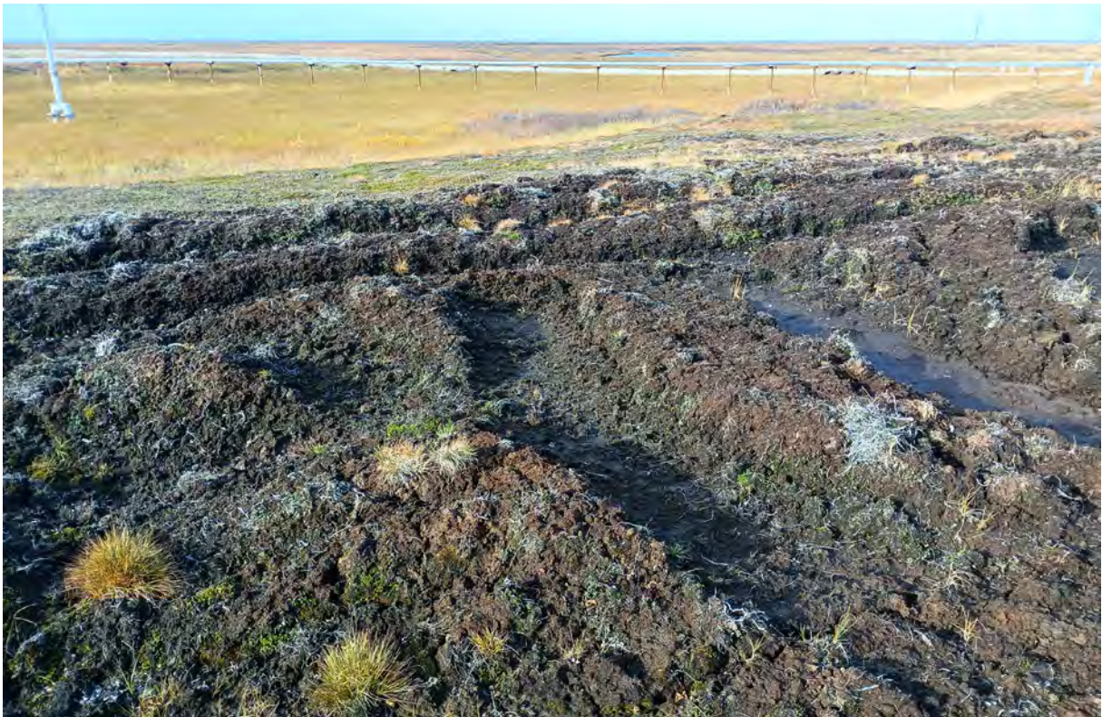
Рис. 35. «Автомобильная дорога АД24 на нефтяном месторождении им. Р.Требса». ТФ 25. Вид с ЮВ. Нарушения почвенного слоя антропогенного характера. Фото.
