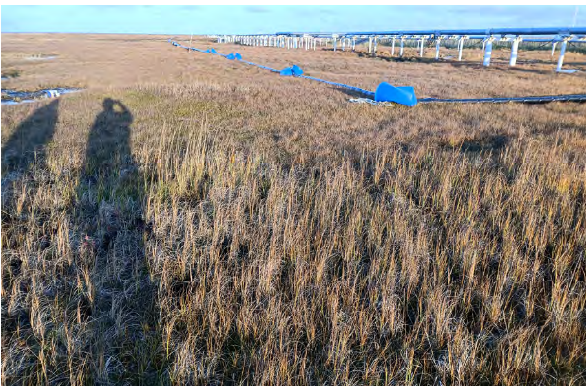
Рис. 118. «Обустройство кустовой площадки К-66 на нефтяном месторождении им. Р. Трбса». ТФ 94. Вид с З. Наземный трубопровод. Фото.
