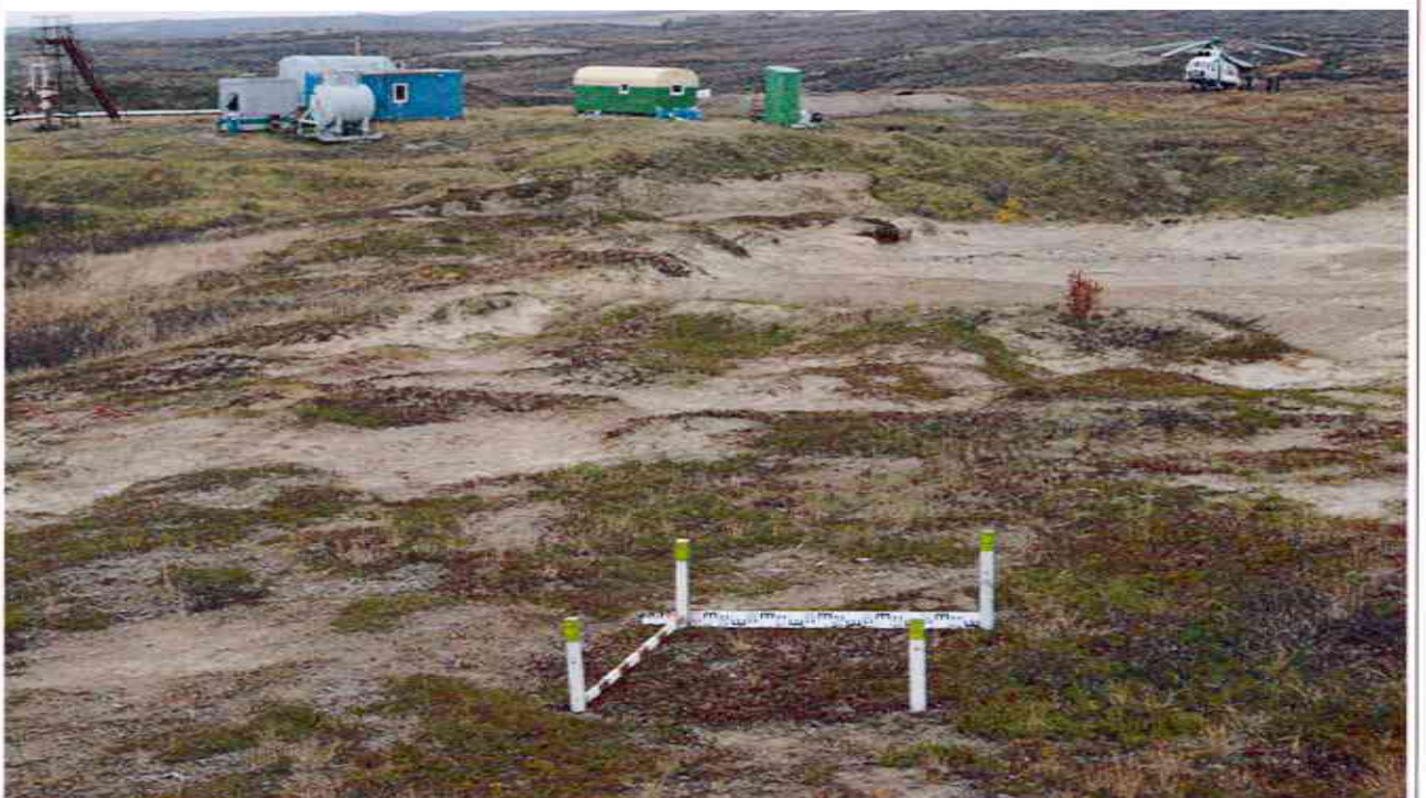
Графическое приложение 5. Фото. НАО. Заполярный район. Восточный участок объекта «Урернырдское месторождение ЦПХ (блок № 4). Одиночная скважина № 30». Место шурфа.
